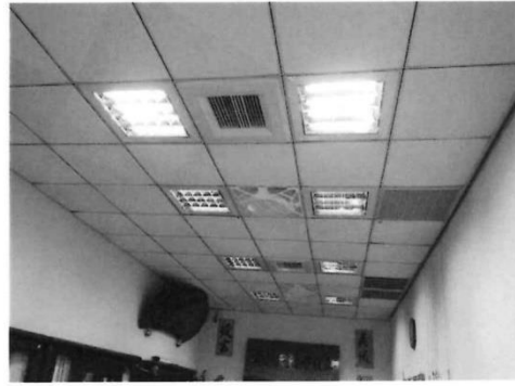
圖 18-擴散型出風口冷氣改善溫差死角
