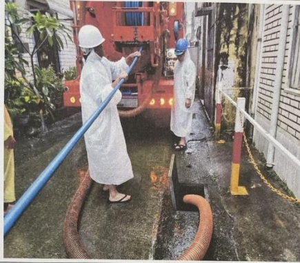
施工中 雙流部落草埔六巷11號後方(活動中心外環道)水溝清淤 暗溝清溝車
