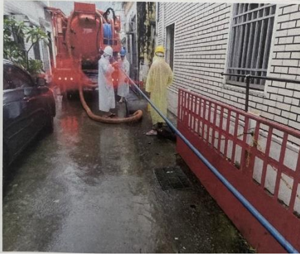
施工中 雙流部落草埔六巷11號後方(活動中心外環道)水溝清淤 暗溝清溝車
